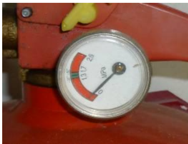
Estintore dal cui manometro è visibile che la pressione interna non è corretta .
